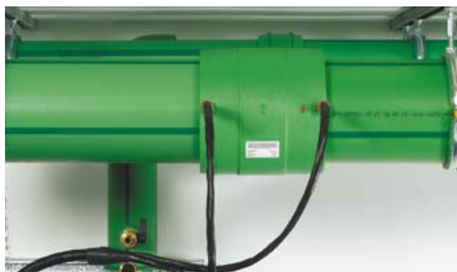
Сварочный аппарат настроить под диаметр муфты. Начать процесс сварки. Выдержать время охлаждения. Готово!
