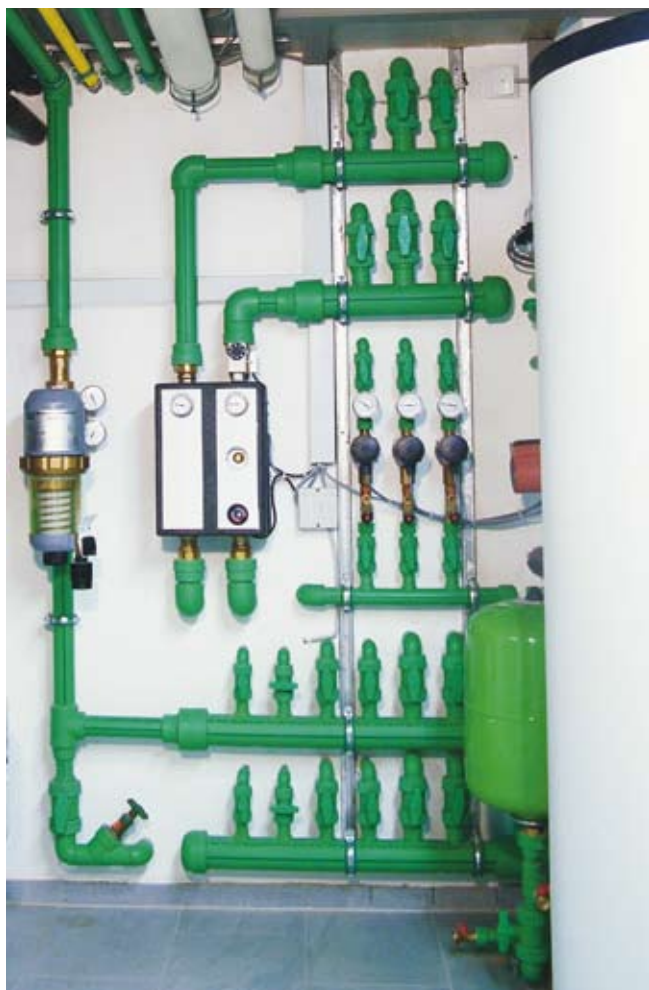
строение распределителя для водоснабжения и отопления в жилом здании
