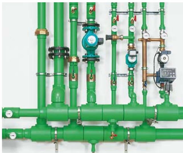
распределитель в системе отопления
